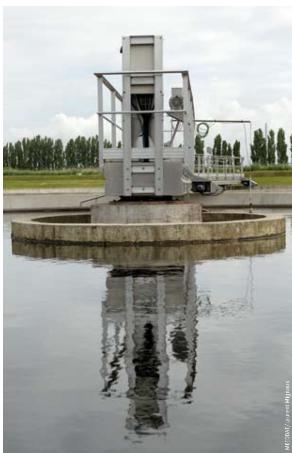
Installation de traitement des eaux usées à la station d'épuration de Honfleur (14)
